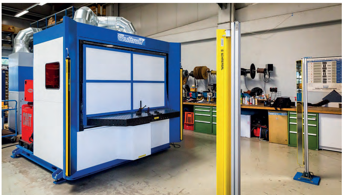
Optoelektronische Sicherheitsschaltgeräte an Maschinen und Anlagen müssen regelmäßig überprüft werden.
